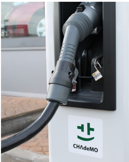
► Poste de carga Chademo
